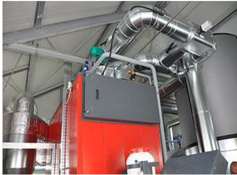
Holz hackschnitzel- anlage Hofbieber mit Nahwärmenetz
