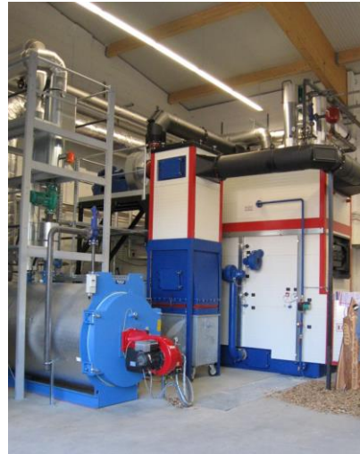
Hackschnitzelanlage Genossenschaft Bioenergie-dorf Burgjoß
