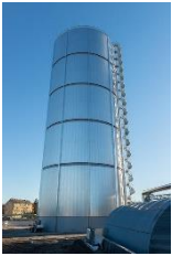
Freistehender Speicher des Nürnberger Wärmenetzes aus Stahl (33.000 m 3 ; D = 26 m; H = 70 m)
