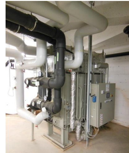
Kälteanlagen Sieben Welten Therme/Hotel
