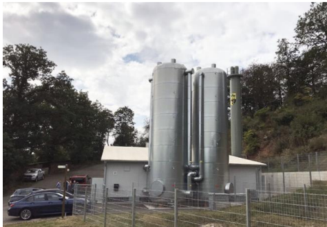
Biomasseheizung zur Wärmebereitstellung im Winter
